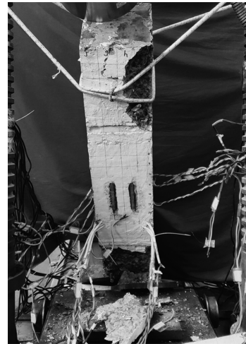
图4 未加固RC柱的破坏形态 Fig. 4 Failure pattern of RC-C
